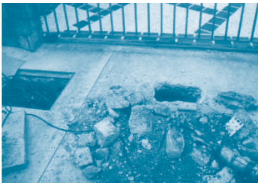
Figura 7: Rotura en Acera para Detectar Toma Clandestina al Troncal de B.T. de la Empresa.
