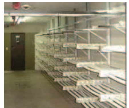
Cables de media tensión con pintura ignífuga SE EUGENIO BLANCO
