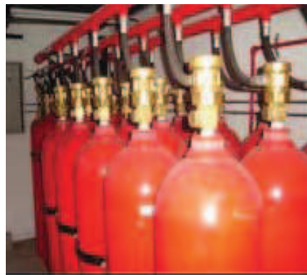
Batería de tubos de CO 2 SE Rivadavia
