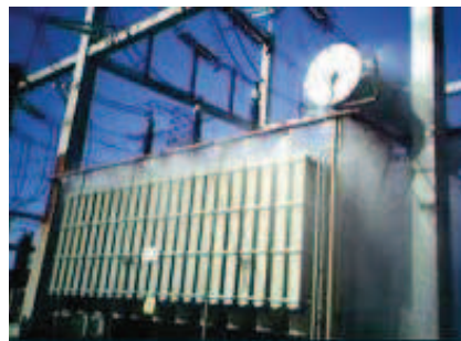
Sistema de agua fraccionada sobre transformador de 300 MVA SE Costanera
