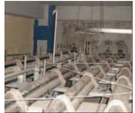
Cables de 132 KV con protectowire y sistema de extinción por agua fraccionada
