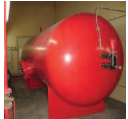
Tanque hidroneumático de 17000 litros SE AZOPARDO
