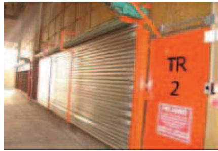
Cortina metálica (Damper) SE Rivadavia
