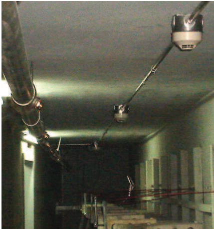
Detección combinada temperatura (protectowire) y humo SE AZOPARDO II
